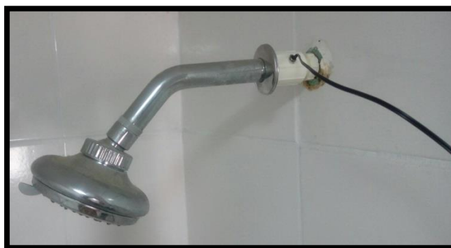
Figura 60 - Sonda instalada na ducha
