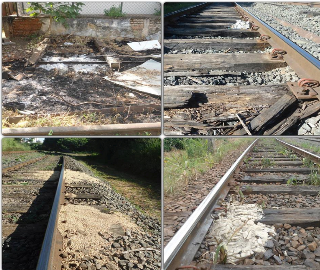
Figura 11: Trecho entre o Viaduto Prefeito João Baptista De Oliveira Romano e a Rua Carioba em situação de abandono
