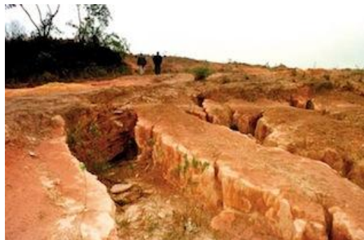
Figura 5.2: Trecho com erosão. Fonte: Site Brasil Escola (2013).
