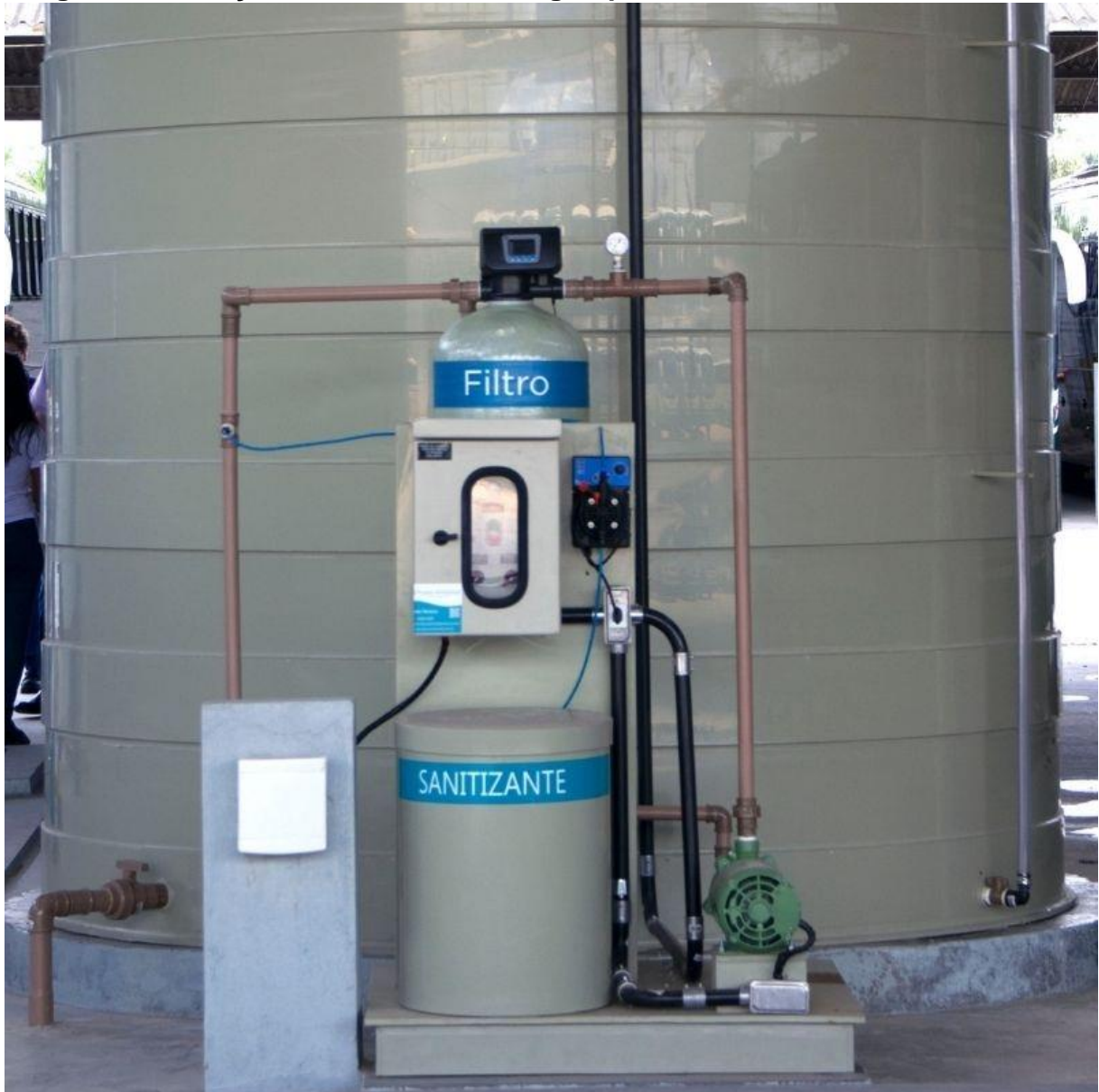
Imagem 15- Estação de tratamento de água pluvial PRO ETA
