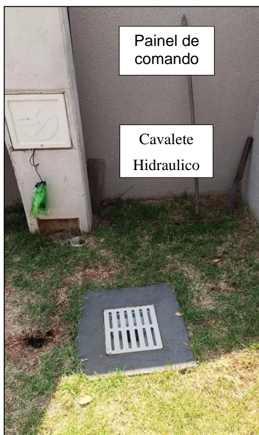
Figura 1. Local de instalação do cavalete e painel de comando.
