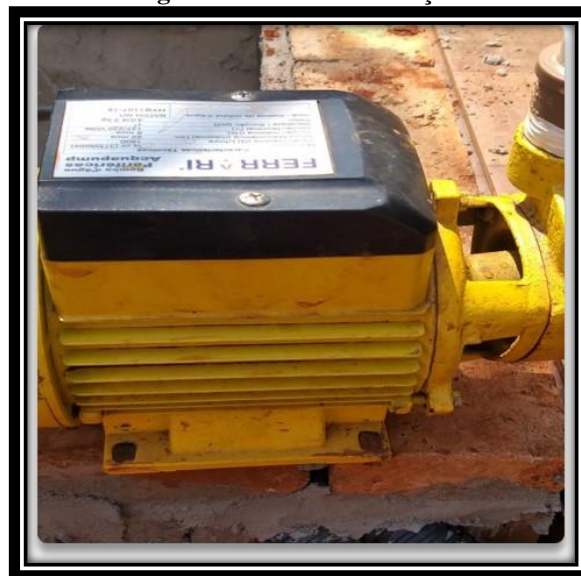
Figura 12: Bomba de Sucção
