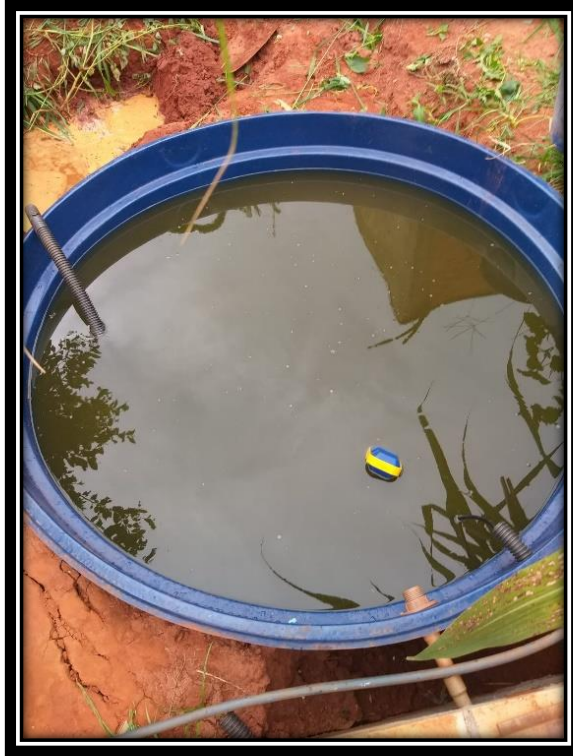
Figura 30: Boia B1 no Decantador Secundário
