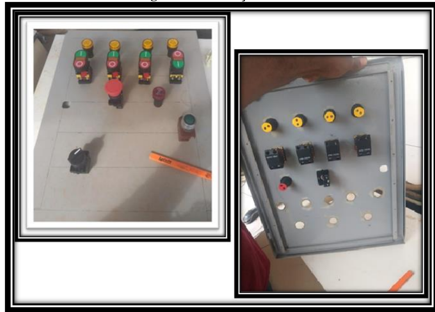
Figura 37: Marcação na Porta
