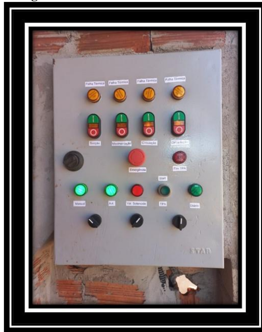
Figura 54: Sinais de Falha Térmica
