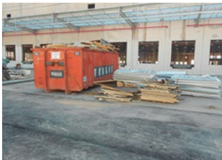
Figura 27 - Caixa Rollo on / Roll off contendo resíduos de madeira
