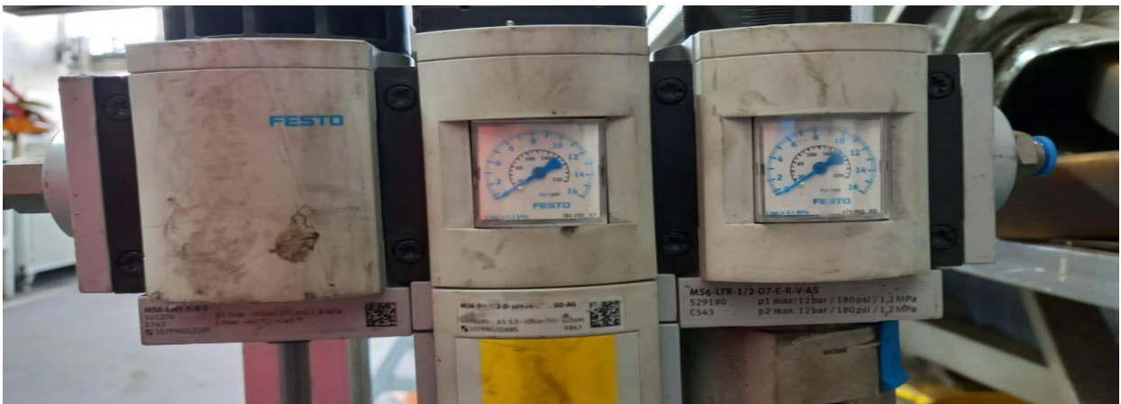
Figura 11. Unidade de ar comprimido.
