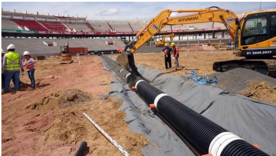
FIGURA 27: Sistema de Drenagem a Vácuo no Beira-Rio (RS) FONTE: SITE GLOBO ESPORTE
