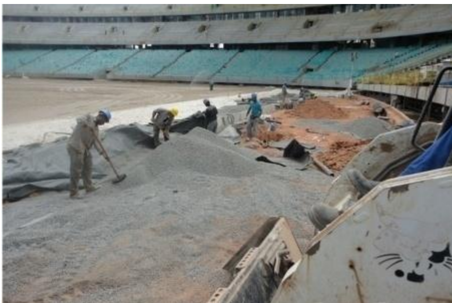
FIGURA 40: Separação e Filtração em Sistema de Drenagem no Gramado da Arena Fonte Nova (Salvador-Ba)
